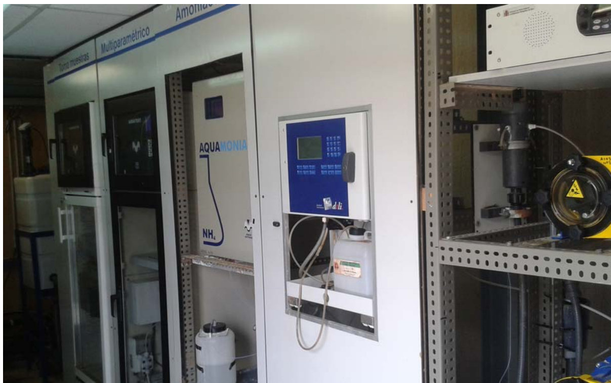
Estación de alerta "Alcanadre en Ballobar". Vista de los equipos.
