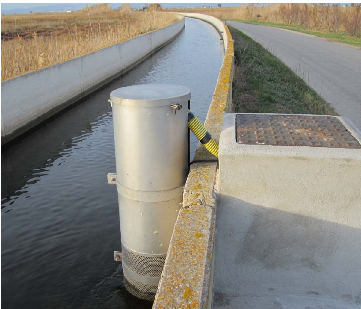
RIADE. Bomba de captación sumergida en canal de agua limpia (964 - Pont de Través)
