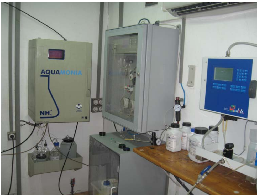
Estación de alerta "Ebro en Ascó". Vista de los analizadores tras la reforma.
