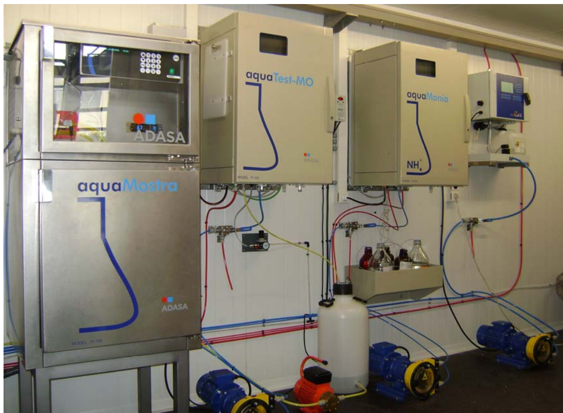
Estación de alerta "Ebro en Xerta". Vista de los analizadores instalados.
