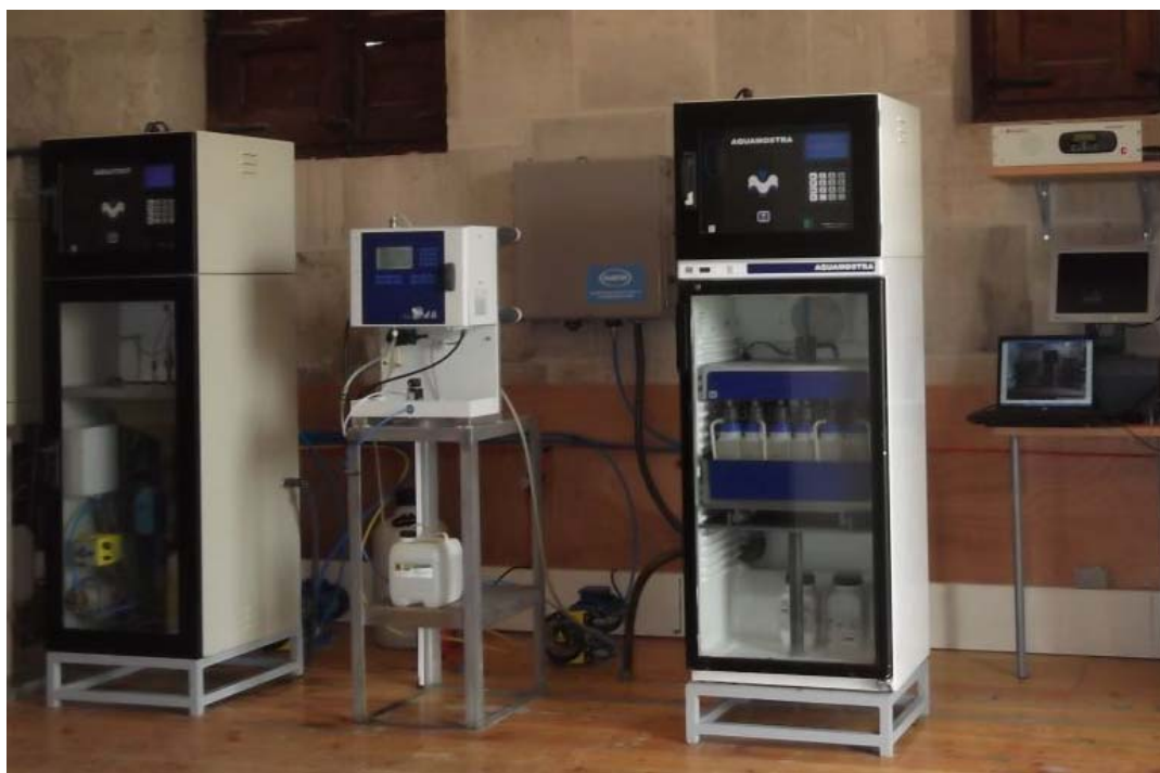
Estación de alerta "Ebro en Pignatelli-El Bocal" Fotografía de algunos de los analizadores instalados.
