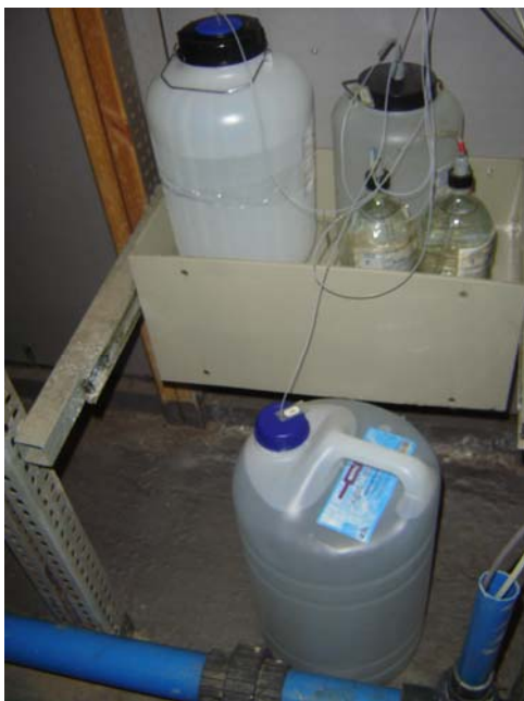
Recipientes con reactivos del analizador de amonio. Permiten el funcionamiento desatendido durante más de 15 días.
