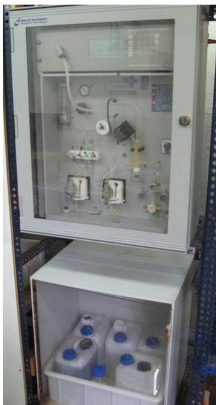
Analizador de mercurio instalado en "Ebro en Ascó"
