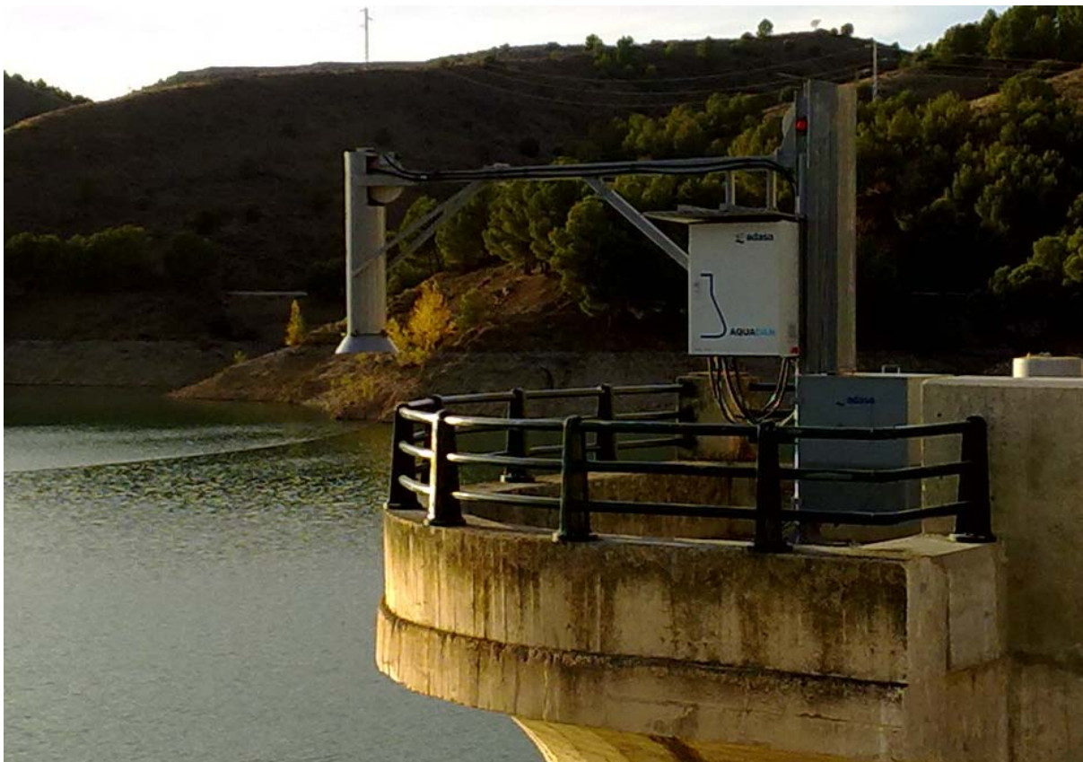
Sonda Aquadam instalada en el embalse de La Tranquera
