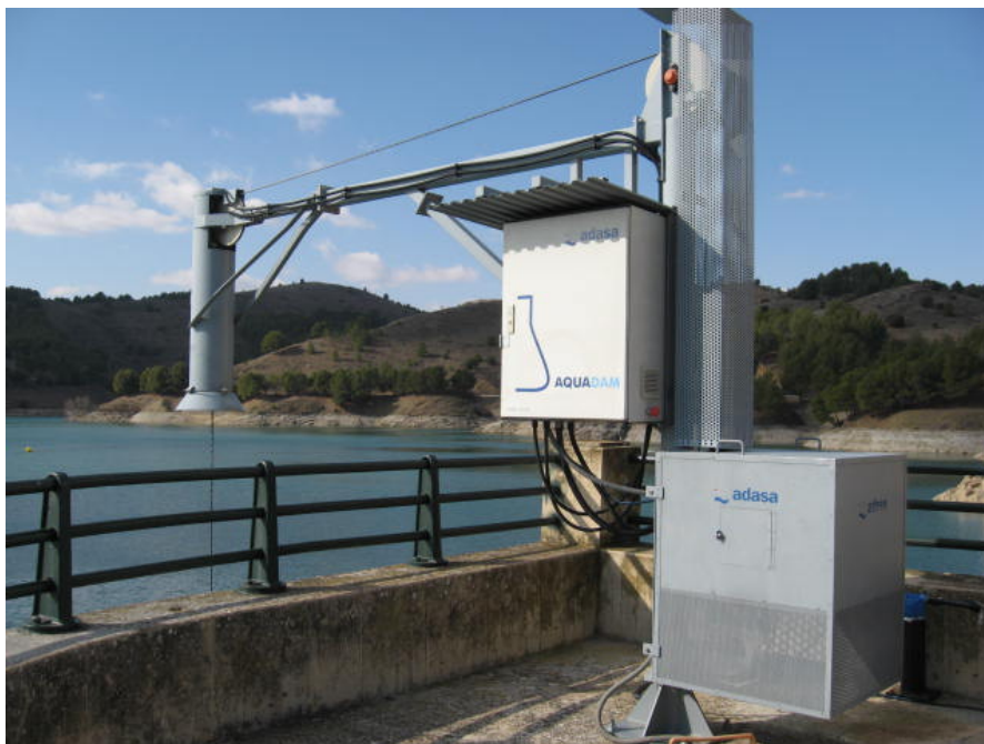
Sonda Aquadam instalada en el embalse de La Tranquera
