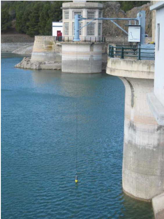
Sonda Aquadam instalada en el embalse de La Tranquera
